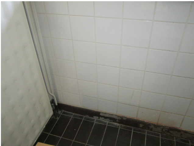
10- pesuhuone, ilmaisu ulkoseinän lattianrajaan (patteriputket), reagointia viemärin kohdalla
