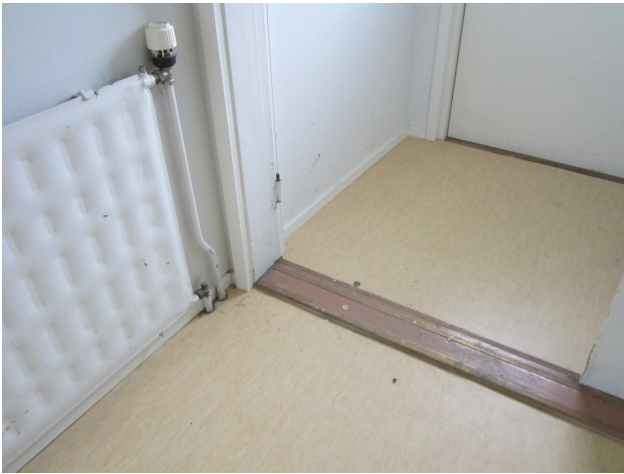
24- eteinen, ilmaisu väliseinän lattiaanrajaan (patteriputket)
