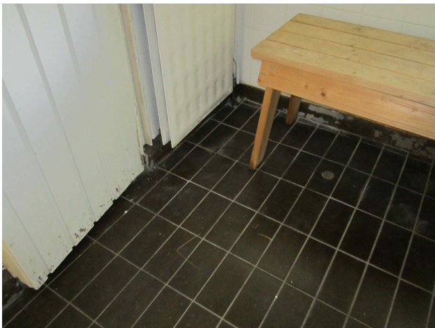
9- pesuhuone, ilmaisu lattiaan
