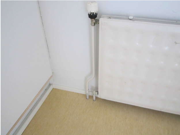
13- aputila, ilmaisu ulkoseinän lattianrajaan (patteriputket), reagointia toisella seinällä
