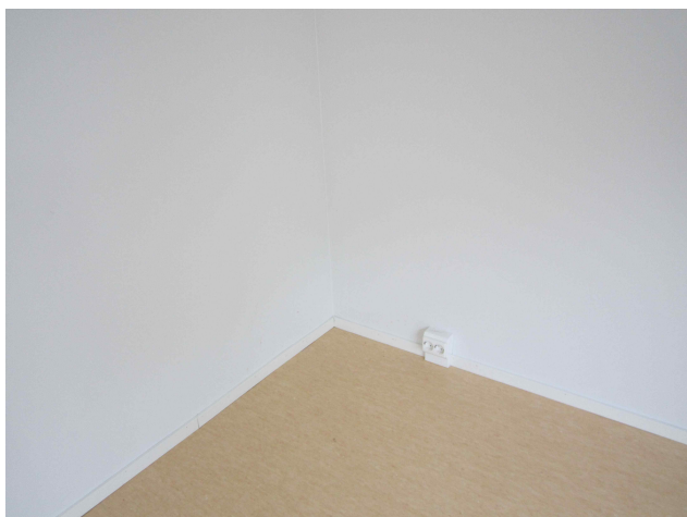
38- huone5, ilmaisu väliseinän nurkkaan lattiaanrajaan (pistorasia)
