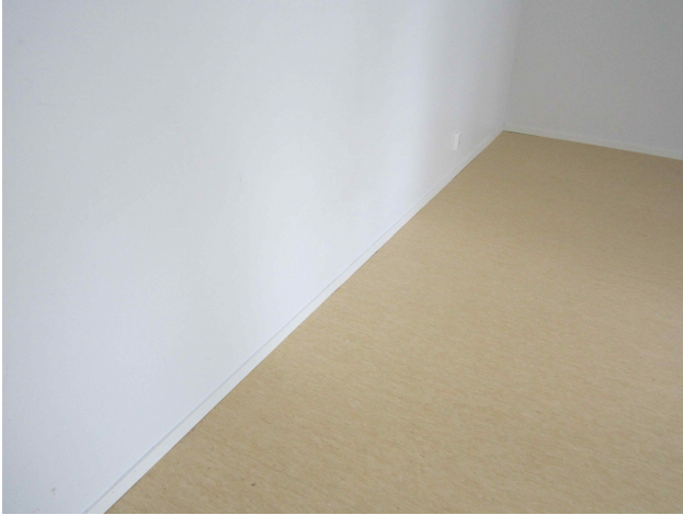
34- huone4, ilmaiset väliseinän lattiaanrajaan
