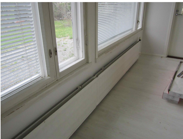
21- olohuone, ilmaisu ulkoseinän lattiaanrajaan
