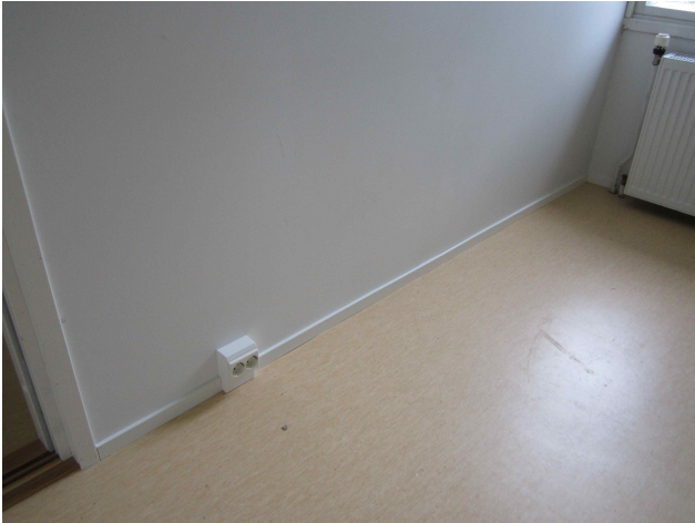
30- huone3, ilmaisu lattiaan, reagointia lattianrajaan pistorasian kohdalla
