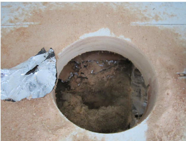
18- keittiö, ilmaisu komeron lattiaan tehtyyn reikään
